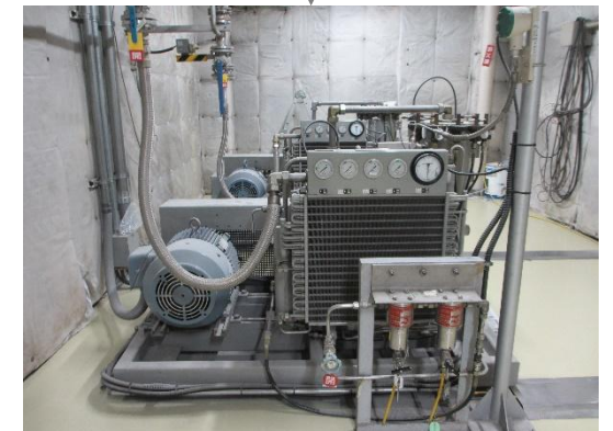
回収圧縮機 Gas Compressor
